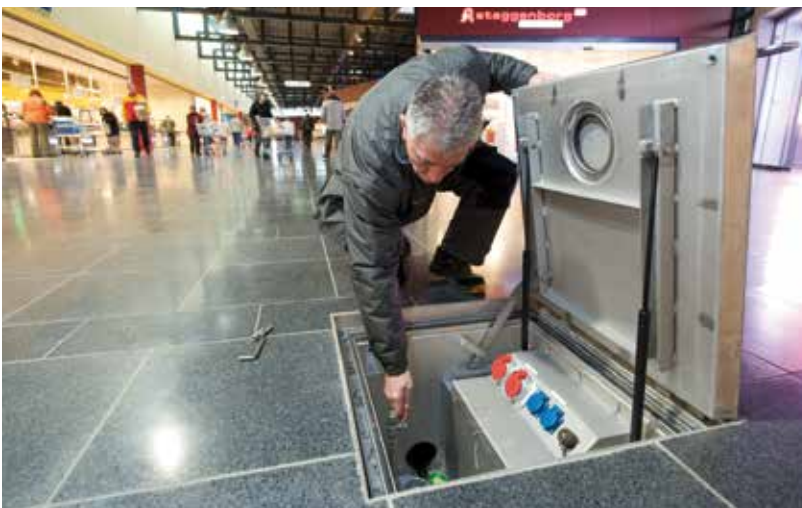
Galerie marchande : trappe assistée pour un accès facile aux réseaux techniques
