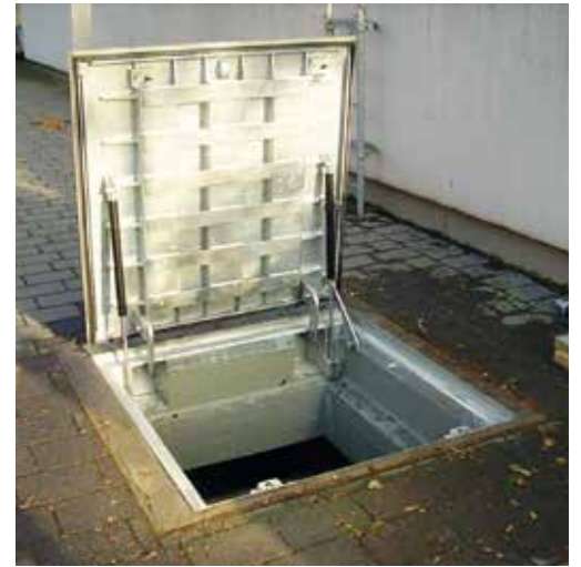
En extérieur : trappe assistée pour un accès facile aux réseaux divers
